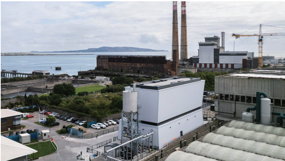
図5 Ringsend排水処理プラントに隣接するリン回収施設全容
