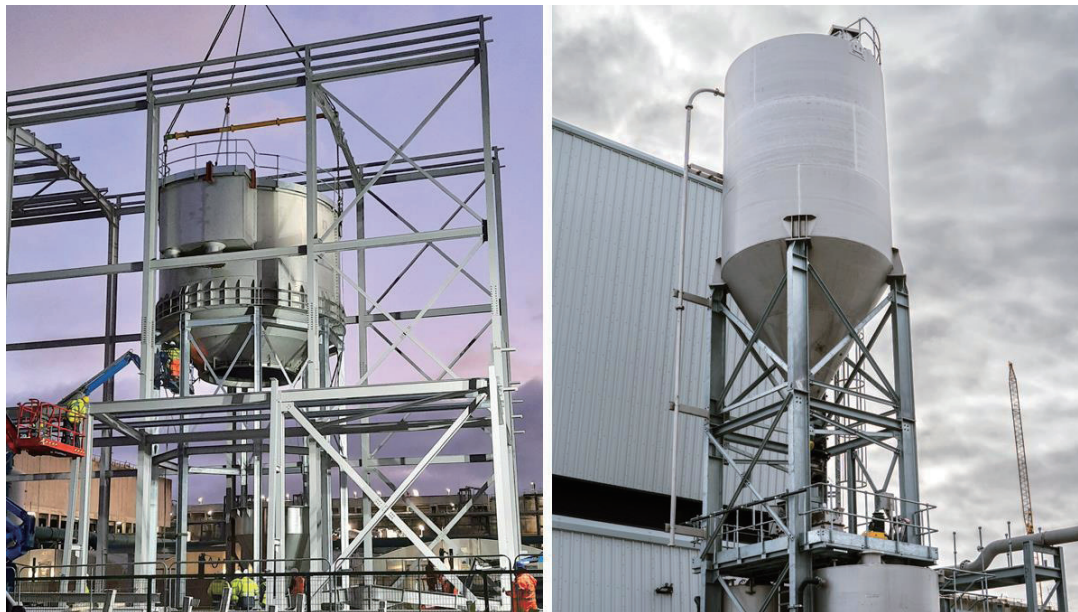
図1 左側：リン反応器（リアクタ）、右側：酸化マグネシウム貯蔵サイロ 出典：M. Ireland, “Ringsend WwTP: Phosphorus Fixation (2023)”, December 4, 2023, Water Projects Online
