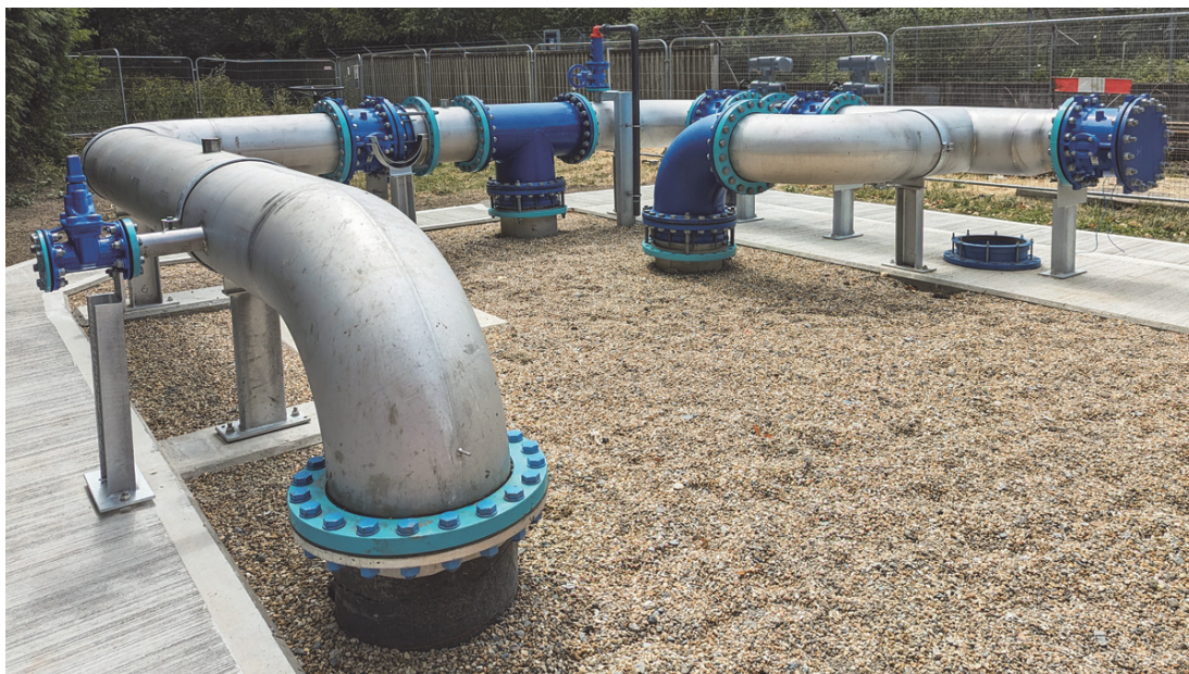
図6 地上部のDN450排管
