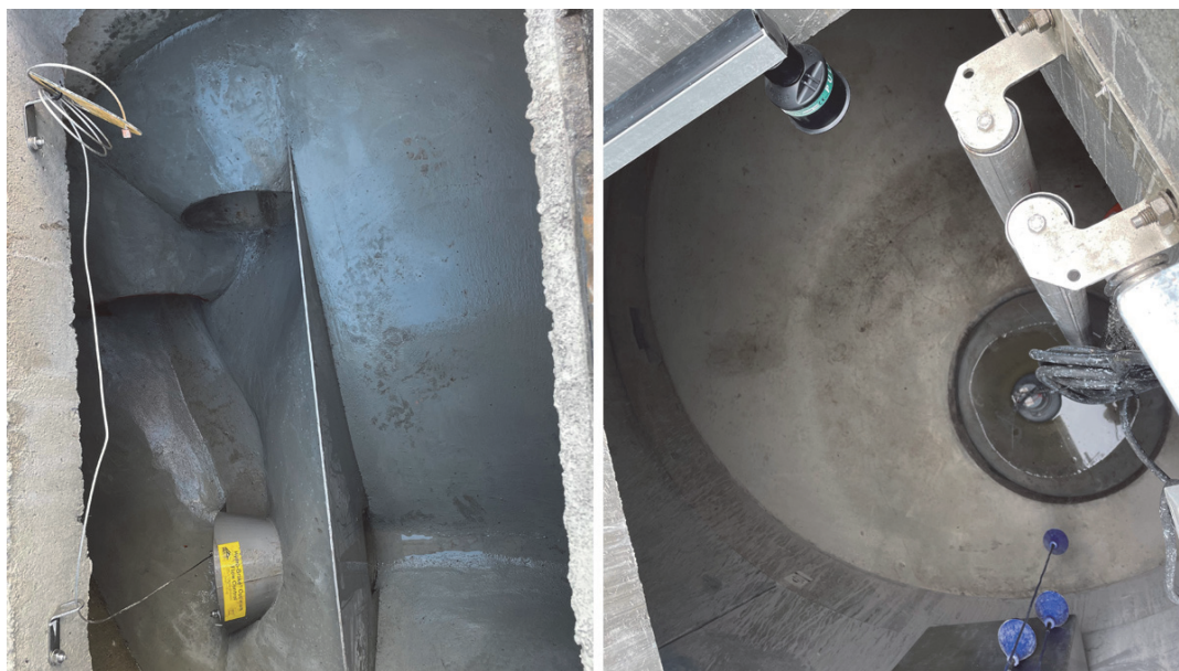
図1 左側：溢水防止堰、Hydro-Brakeを備えた流水制御チャンバー（室）、 右側：フロート制御ポンプとガイドが設置された30m 3 豪雨水用タンク
