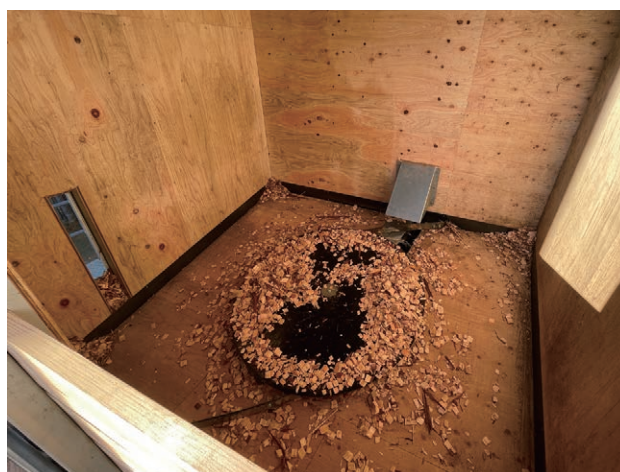
写真2 コンテナパッケージボイラ内装
