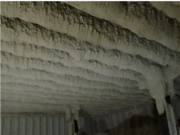
装置導入前 過熱器 (100日間運転後)
