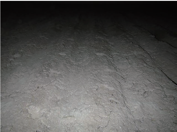
装置導入前 放射伝熱面 (200日間運転後)
