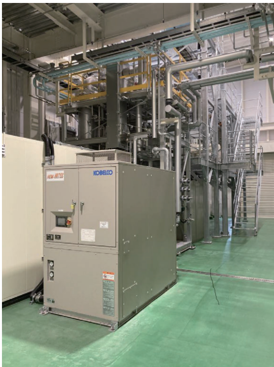
写真1 最近の当社納入設備のヒートポンプ設置状況
