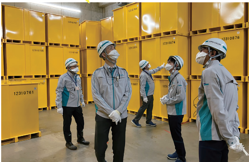
放射性物質濃度の高い灰処理ばいじんが充填された鋼製角形容器は、30cm厚のコンクリートで囲まれた保管庫で一時保管。その後、外部の貯蔵施設に移送され、30年間保管されます。
