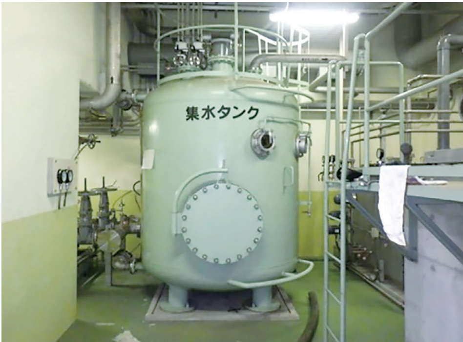
写真1 集水タンク外観
