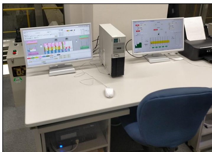
図表 9 ごみピット 3D システムとごみクレーン AI 自動運転装置の外観
