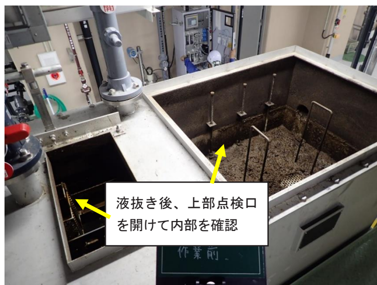
図表 10 槽外型リアクタの点検作業
